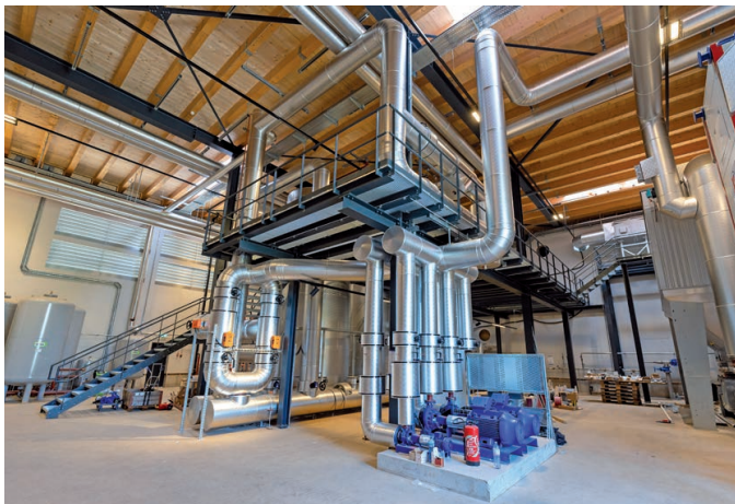
La zone de distribution de la centrale de chauffage à bois du CAD Santal.
