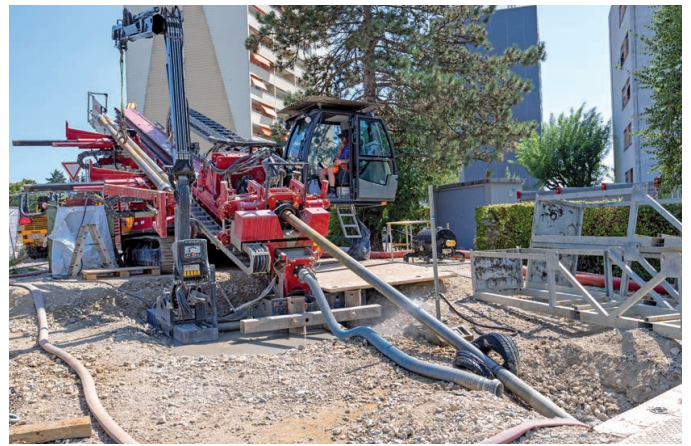
Un défi pour Y-CAD : le forage dirigé à l'avenue Kiener permettra de passer des conduites de transport de chaleur sous la Thièle.
