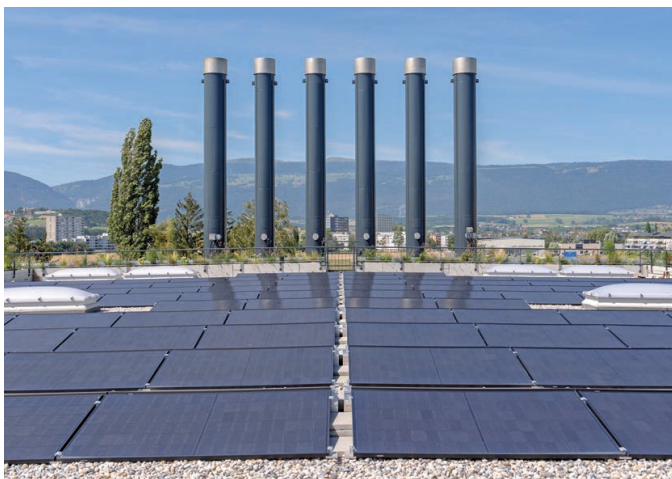
Le toit de l'unité principale, avec des panneaux photovoltaïques et ses six cheminées.
